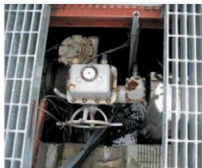
【緊急自動遮断弁】
