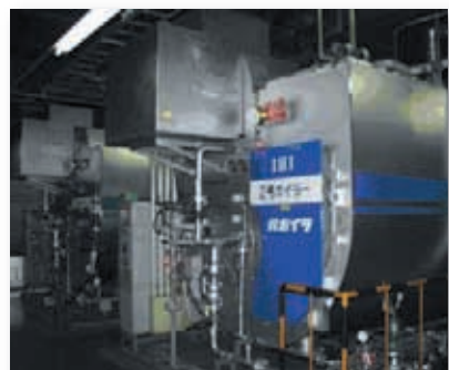
【炉筒煙管ボイラー】
