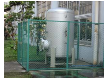
SF 6 ガス回収装置
