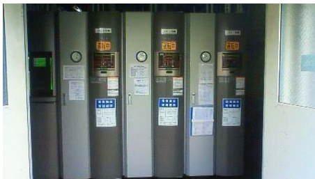
小型ボイラー
