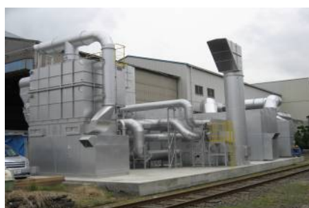
VOC物質除去装置(分離・濃縮・焼却施設)
