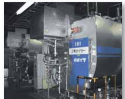
【炉筒煙管ボイラー】
