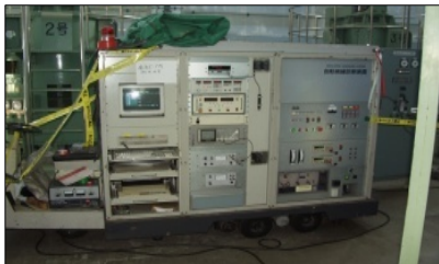
高圧電動機絶縁診断
