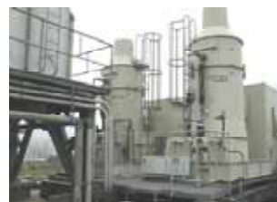
【排ガス洗浄装置】
