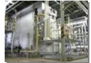
ボイラー設備
