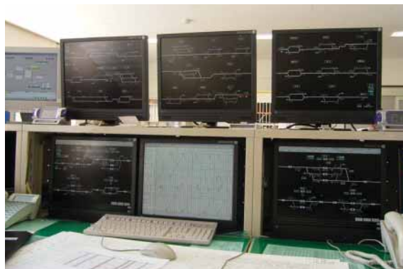
肥薩おれんじ鉄道向け 自動進路制御装置 Train traffic control system for Hisatsu Orange Railway
