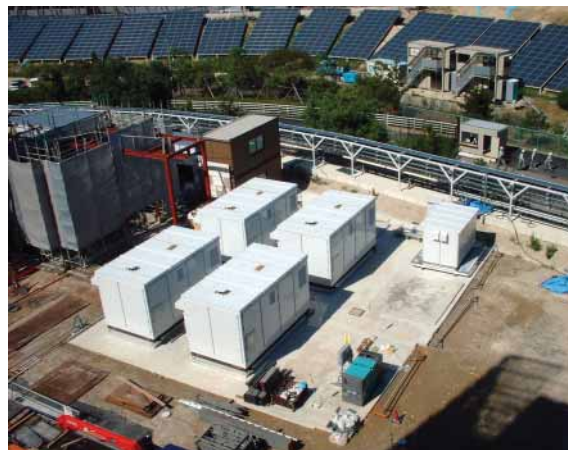
愛知万博会場に設置されたりん酸形燃料電池システム Phosphoric acid fuel cells (PAFCs) installed on grounds of EXPO 2005 Aichi J-pan
